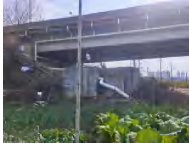
涿水大桥2桥面雨水径流收集系统及缓冲事故池
