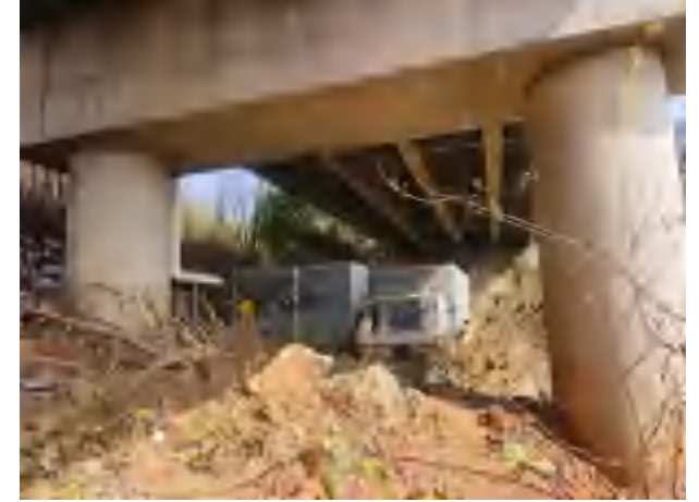
涿水大桥3桥面雨水径流收集系统及缓冲事故池
